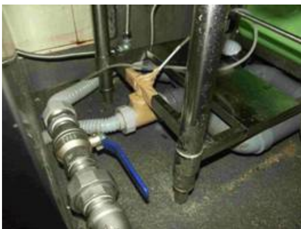
(18) 処理水採水口設置状況
