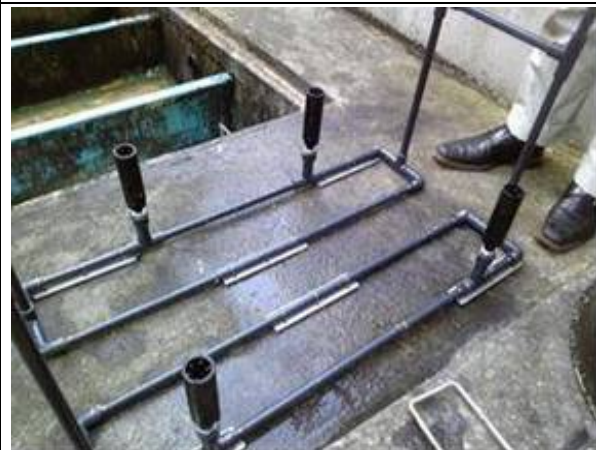
(6) 円筒状オゾンエア注入器
